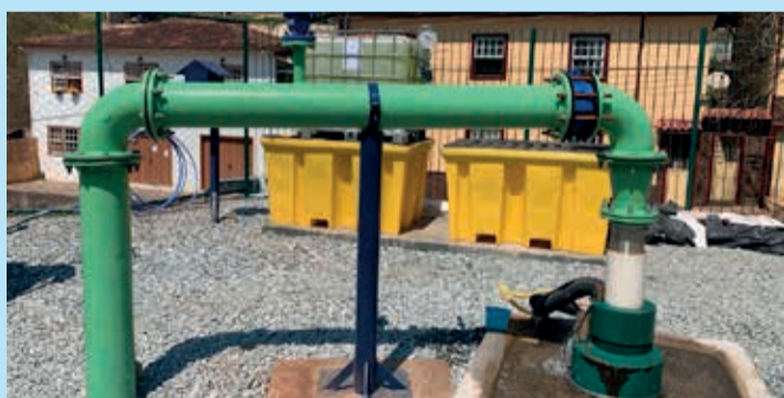
Operação do poço do bairro Água Limpa
